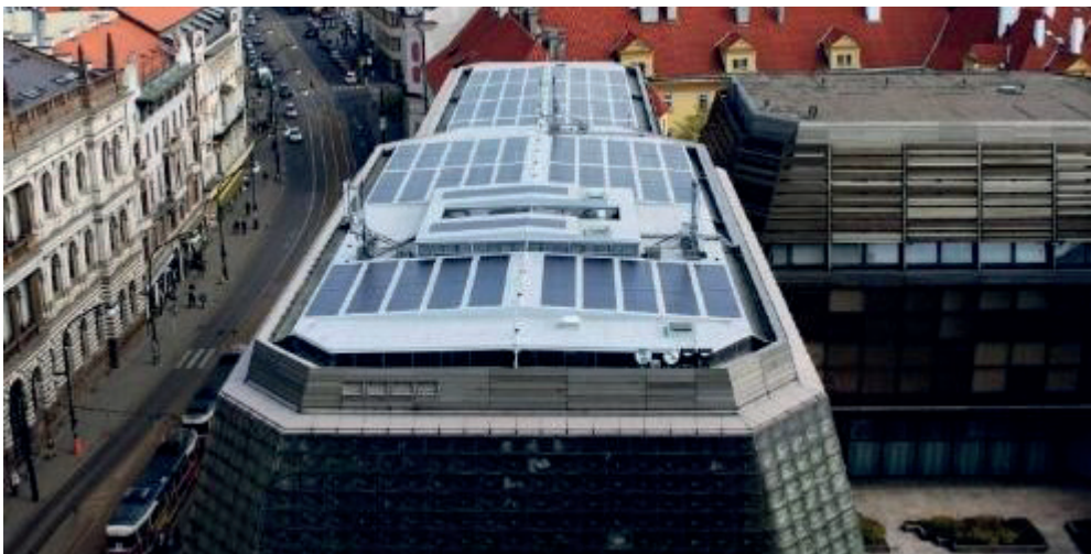
Obrázek č. 10: Fotovoltaická instalace na střeše budovy Nové scény Národního divadla, Zdroj: vtm.e15.cz
