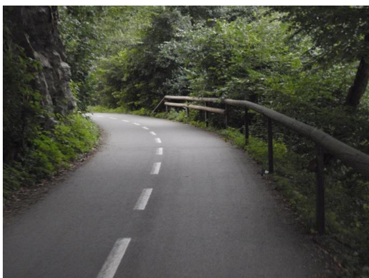
Obr.35. Dřevěné zábradlí nad svahem (Bílovice nad Svitavou)
