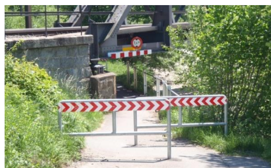
Obr.34. Zábradlí upozorňující na zúžený a snížený průjezdný prostor pod mostem (Švýcarsko)
